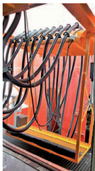
Kablage för landström.
