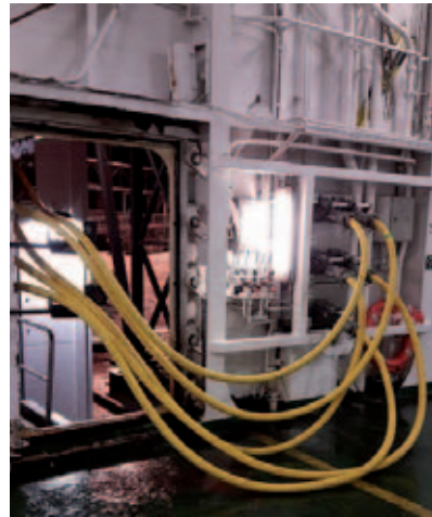
Landströmsanslutningens kablar förser M/S Rosella med ström.
